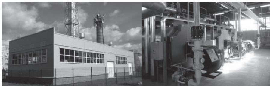
Рис. 2 Новая блочно-модульная котельная
